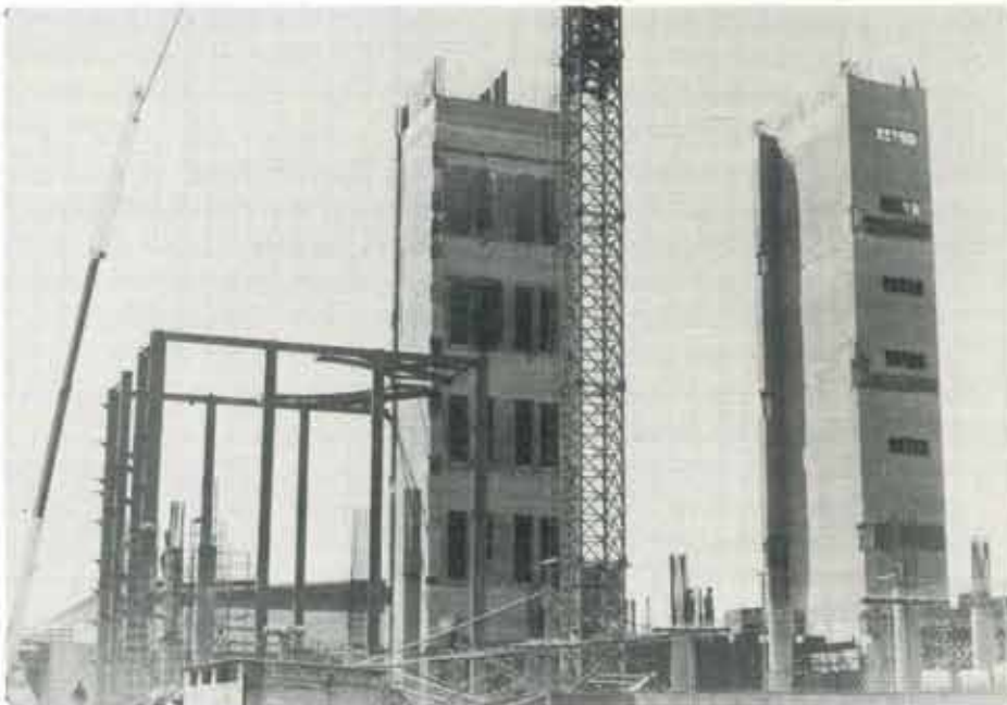
Som ett benrangel reser sig den nya fabriken stålkonstruktioner mot skyn. De två höga tornen är hiss-schakt. Konstruktionen, som syns längst ner i vänstra hörnet är för spraytornet.
