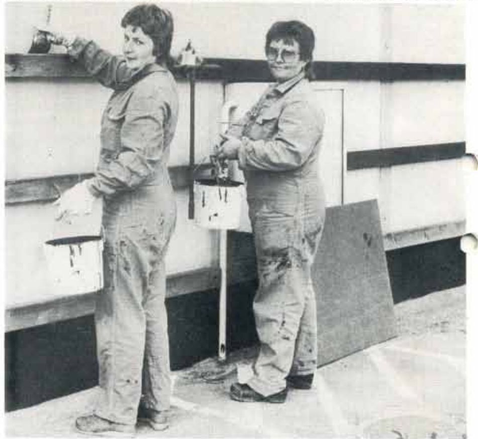
ANNIKA WIDEN, lagret (t.v.) och KARIN NORDIN, pulverpackningen har varit utlånade till verkstaden och gått på målningsarbeten. "Synd bara att det är svartmålning" skojar de när de målar socklar och skyddslister på en av lagerhyggnaderna. Annars tyckte inte flickorna de va så tokigt. Bra att kunna om man ska reparera hemma själv, menar Karin.
